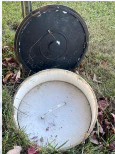
Frost lid positioned inside meter pit.
